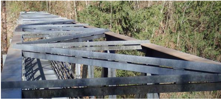
Abbildung 2: Rostende Obergurte der Tragkonstruktion
